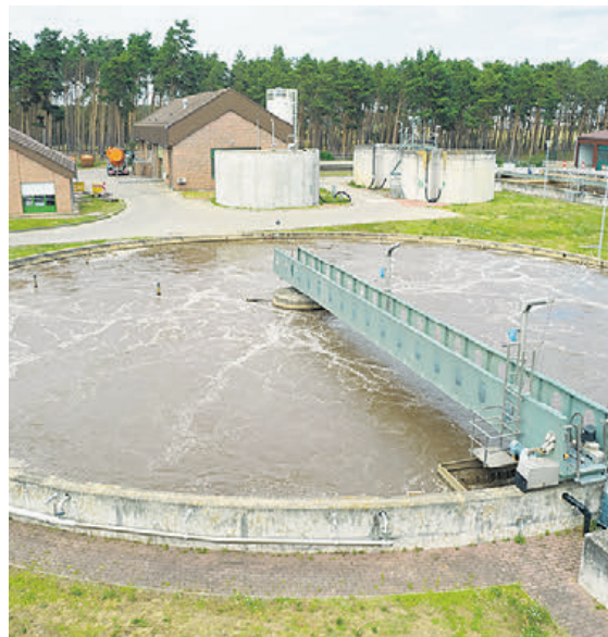
Die Kläranlage des WAZV „Elbe-Elster-Jessen“.
