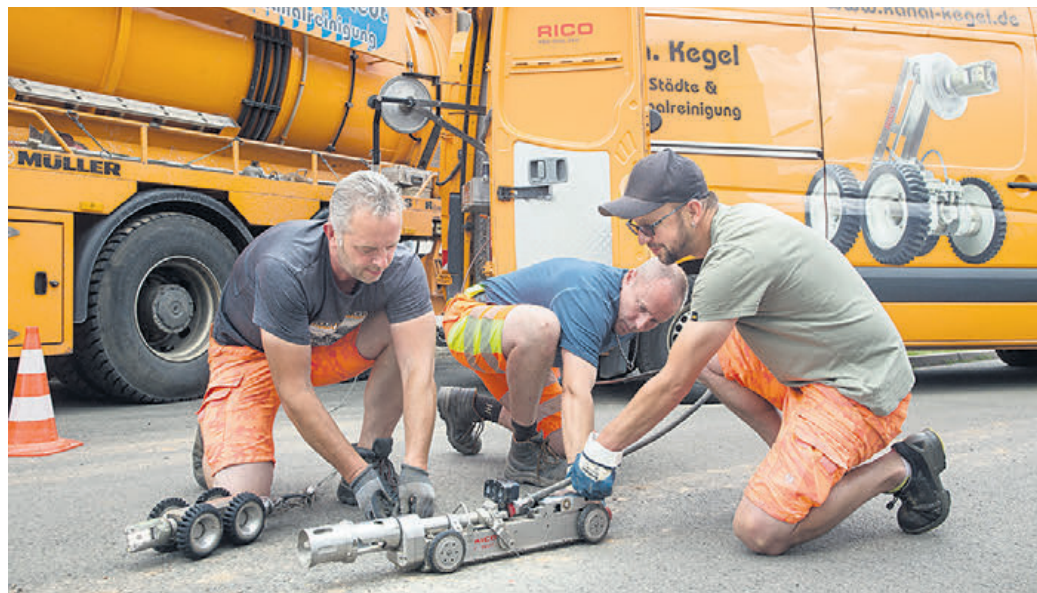
Mathias Bohlemann, Rochus Schulze und Norman Aust, Mitarbeiter der Firma Kegel aus Arnstein, bereiten eine Kamera für die nächste Erkundungsfahrt vor.
