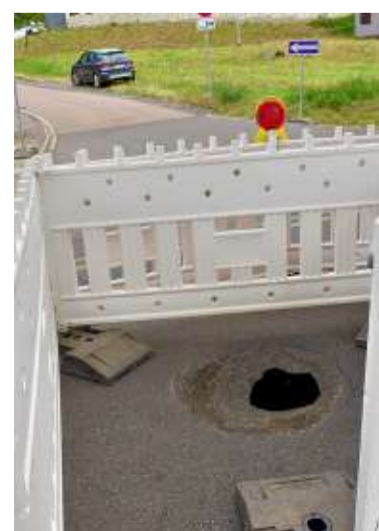
In der Sanderslebener Straße in Hettstedt ist die Fahrbahn eingesackt und ein Loch entstanden. FOTO: LUKASCHKE
